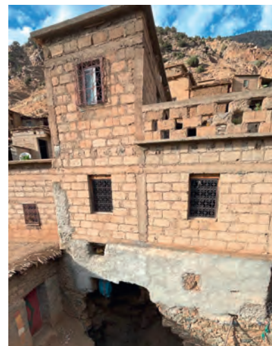
Kaum bewohnbar: Dieses Haus in Amlougui wurde durch das Erdbeben schwer beschädigt. Fotos: zvg
