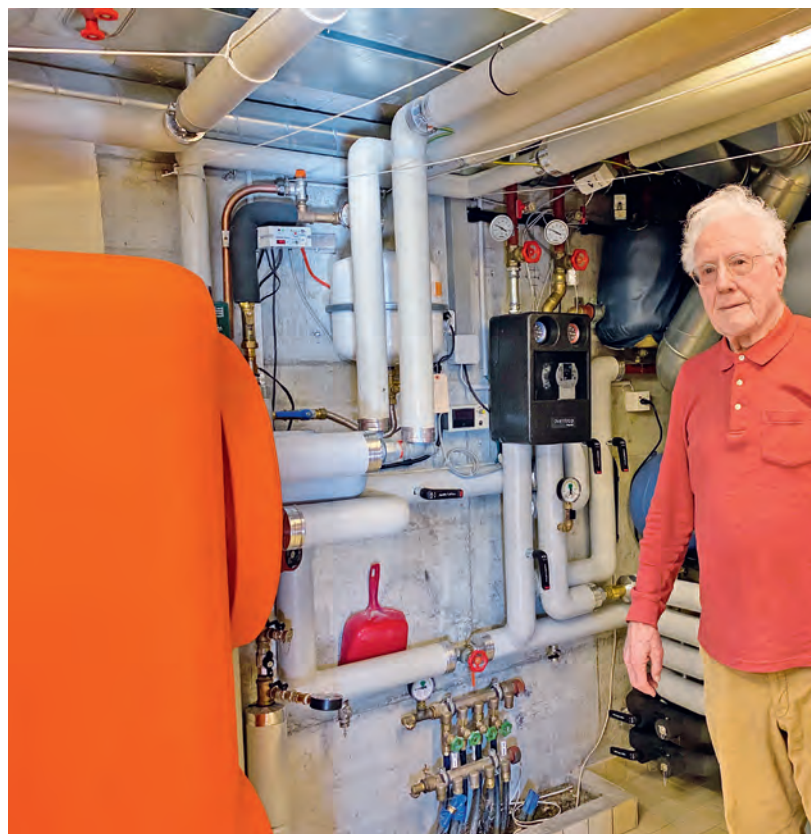
Energiezentrale: Zur Speicherung von Wärmeenergie nutzt Hans-Rudolf Zulliger einen grossen Wassertank im Keller seines Hauses. Foto: Jérôme Stern
