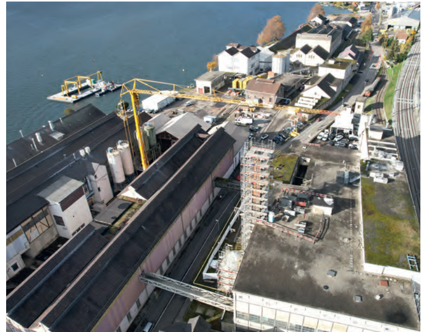
Langer Arm: Der Kran steht wegen Platzmangels auf der anderen Strassen- seite.
